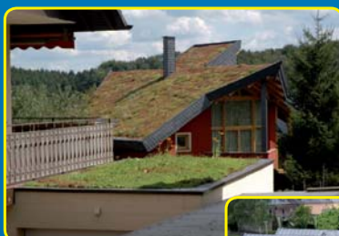
Toit vert incliné à Mitlosheim (D)
