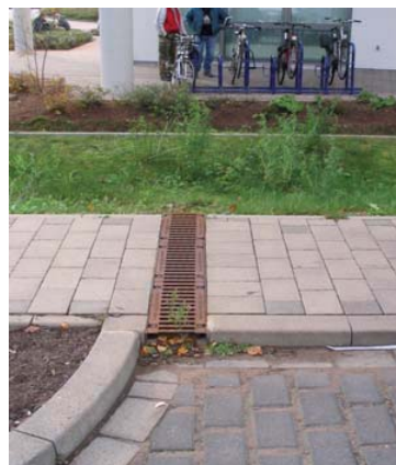
Ecoulement d'eau de pluie d'un parking perméable vers un fossé d'infiltration à l'aide d'une rigole moulée
